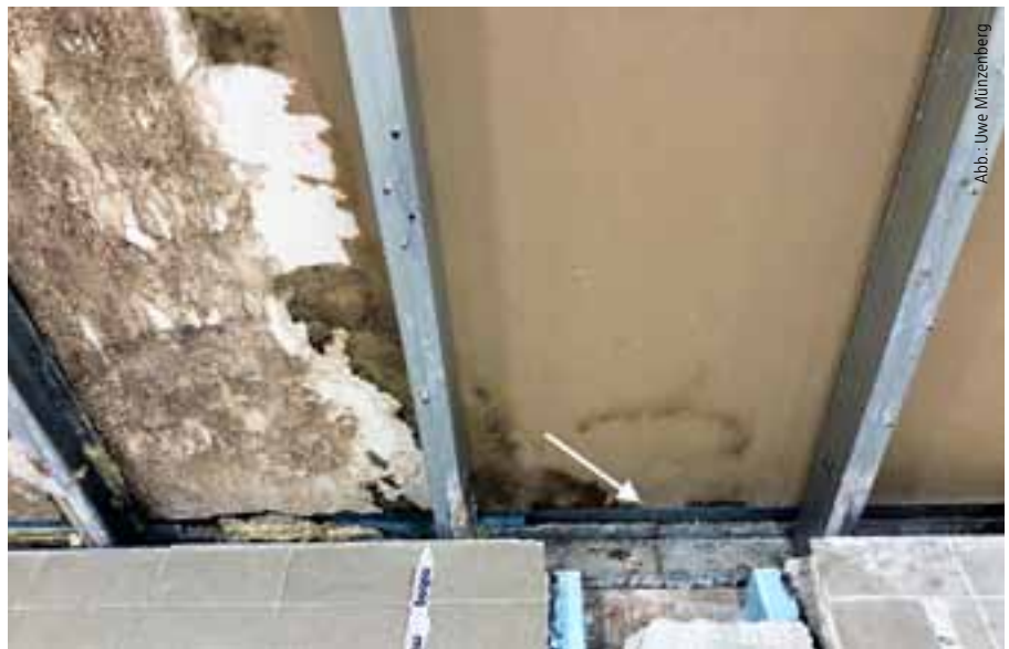
Abb. 5: Beispiel für luftundichte Montagewände: Die GK-Platten wurden nicht bis zur Bodenplatte geführt. Die gesamte Konstruktion ist daher nicht luftdicht. Sporen und andere Schimmelbestandteile können sich so je nach Druckverhältnissen im gesamten Gebäude verteilen.
