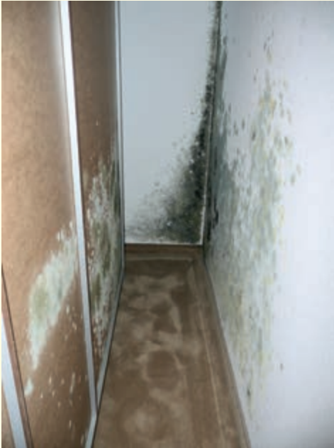
Schimmelpilzbefall hinter einem Schrank
